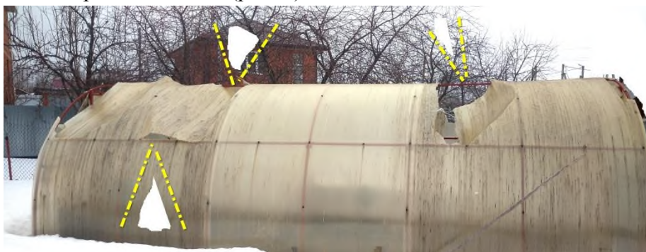
Рисунок 2. Разрушение поликарбоната и провал снега внутрь теплицы
