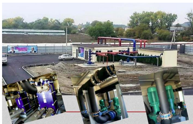
Рис. 2. Геотермальная станция Ханкальского МТВ (скв. 1-ДГТ и 2-НГТ)
